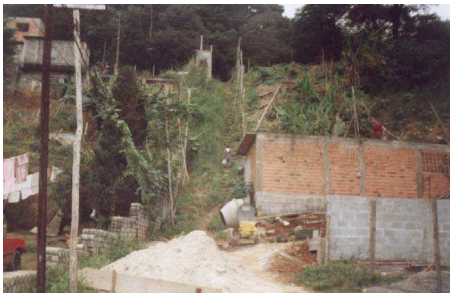
Figura 17 – área de risco – talude(sd), DBH
