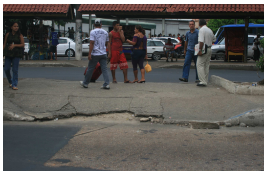
Imagem 16 – Desníveis na calçada. Praça da Matriz.
