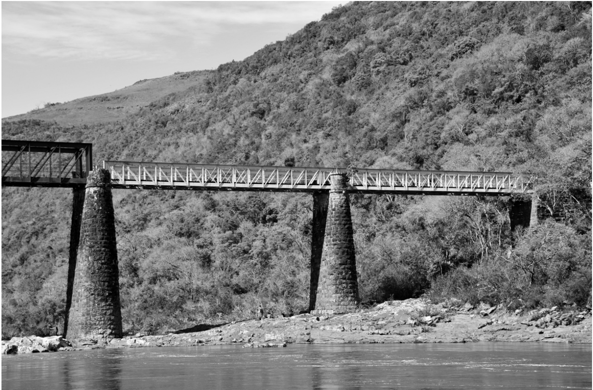
IMAGEM 13 – Ponte do Korff construída em 1904 na Estrada Rio Branco sobre o Rio das Antas no Distrito de Criúva em Caxias do Sul a 30 km de Antônio Prado, entre os municípios de Vacaria e Caxias do Sul no Nordeste do Rio Grande do Sul. Fotografia de 2010. Acervo: Fernando Roveda. Fonte: Projeto Memória – CIBRAP.
